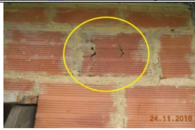
B Bloques instalados con deficiencias de calidad
