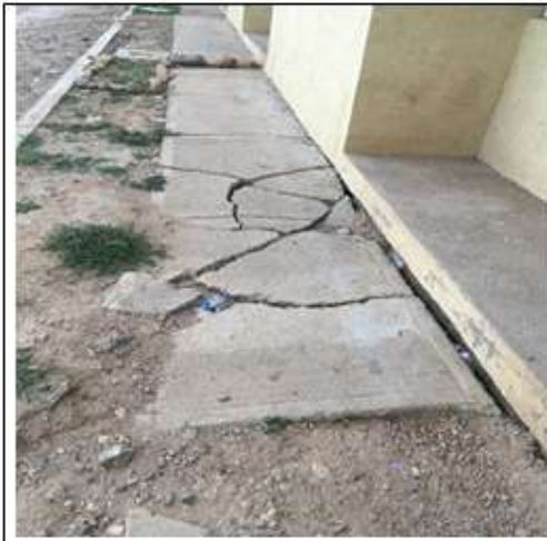
Andenes fracturados y con desprendimiento, sin reparación alguna
