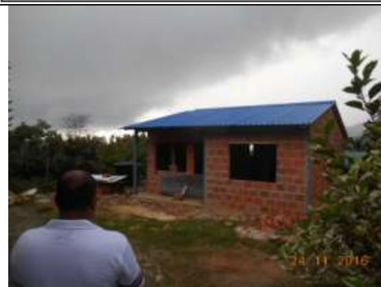
V Viviendas semi-construidas, con obras paralizadas por falta de materiales.
