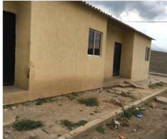
Desprendimiento de andenes y discontinuidad de estos elementos en varias viviendas.
