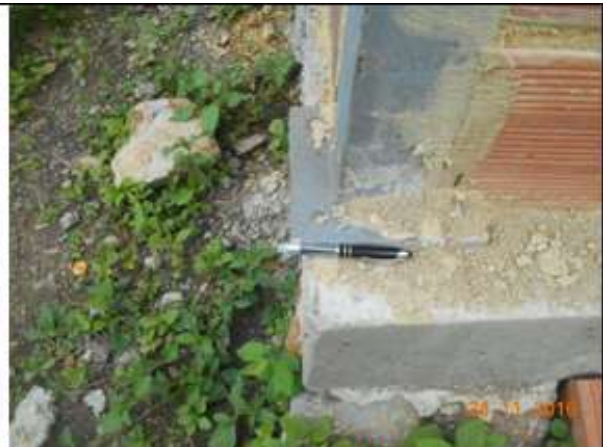
Anclajes en voladizo sin tornillos de anclajes
