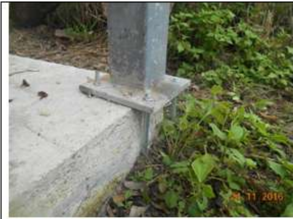
Anclajes instalados en voladizo, sin que sus tornillos se fundan con el concreto
