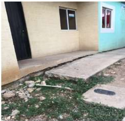
Desprendimiento de andén de la vivienda, puede ocasionar socavación en cimentación, discontinuidad del mismo por cruce realizado posterior para conectar red domiciliaria
