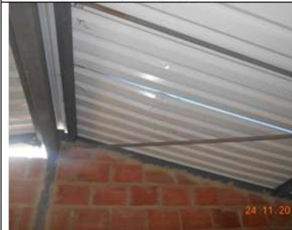
Tejas deficientes instaladas en viviendas semi construidas
