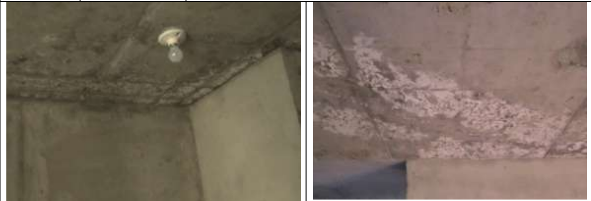
Permanecen algunas filtraciones, a las cuales ISVIMED se comprometió hacer seguimiento, para asegurar la impermeabilización
