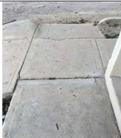
Andenes con fisuras y desprendimiento en las juntas.
