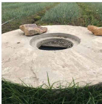
POZO DE INSPECCION SIN TAPA
