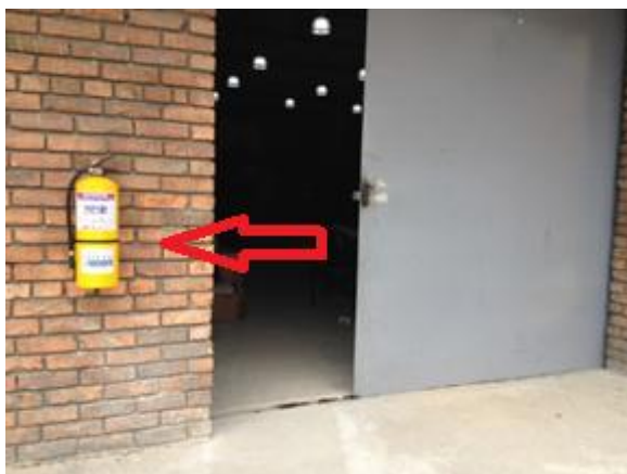
Fotografía 40. Extintor entrada de la bodega 2, Sede La Fragua
