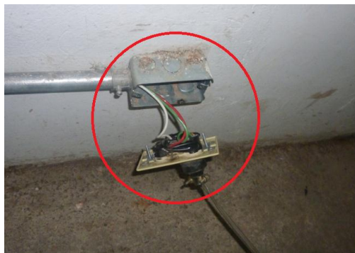
Fotografía 33. Instalaciones eléctricas en mal estado
