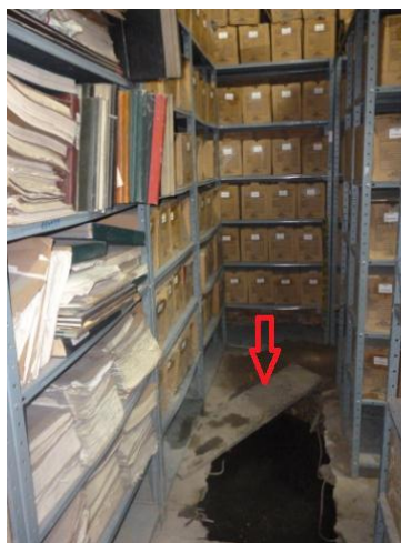
Fotografía 34. Piso en mal estado y con filtraciones cerca a la documentación
