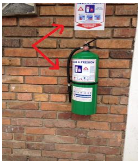
Fotografía 39. Extintor de Agua a Presión y señalización, Sede La Fragua
