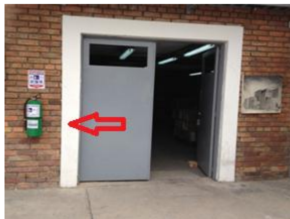
Fotografía 41. Extintor entrada bodega 6, Sede La Fragua
