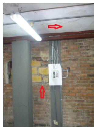
Fotografía 36. Muestras de humedad en techos; paredes en mal estado
