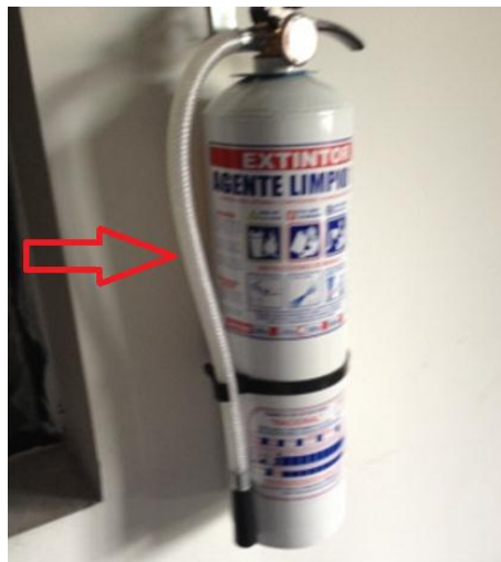
Fotografía 38. Extintor Solkaflam, Sede La Fragua
