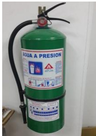
Fotografía 15. Extintor de Agua a Presión
