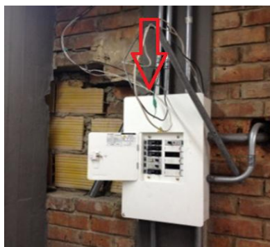
Fotografía 32. Exposición de la instalación eléctrica en las bodegas, Sede La Fragua
