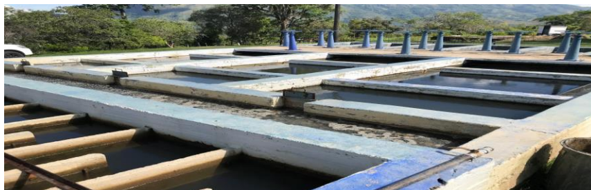
Sedimentador y Filtros Existentes. Municipio De Rovira, Tolima
