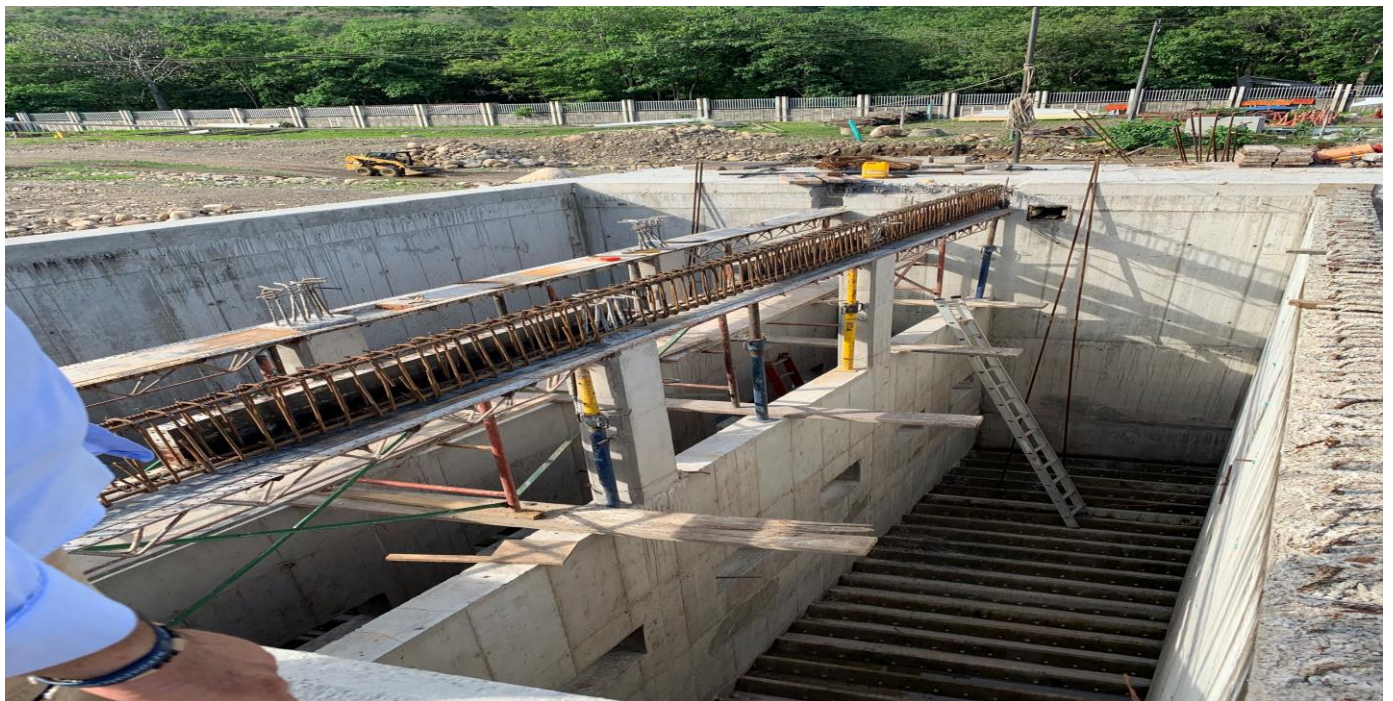
Figura 8. Sistema de Filtros PTAP; Municipio de Yopal, 29 de abril de 2019
