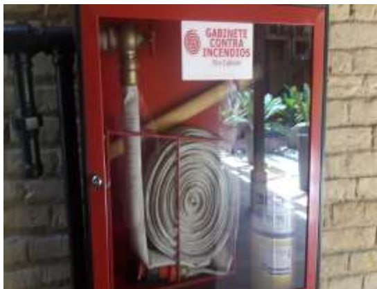
Registro Fotográfico No 1
