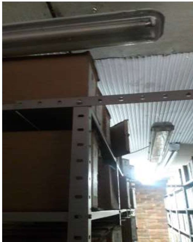
Registro Fotográfico No 20
