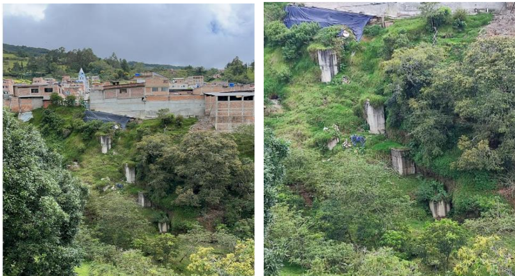
Fotografía 6. Emisario final red de alcantarillado municipio de Belén - Nariño
