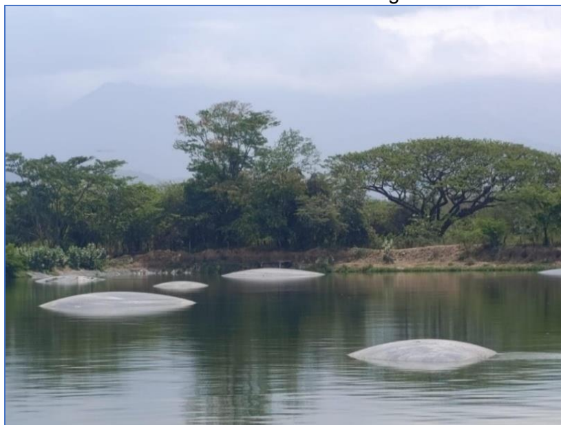
Imagen 3 Estado actual Sistema de tratamiento de aguas residuales de Fonseca.
