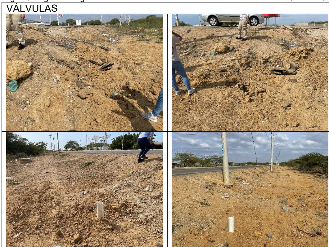
Imagen 6 Registro fotográfico del estado de las válvulas instaladas del contrato 011 de 2021.
